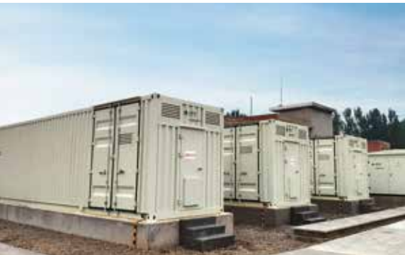
电网侧分布式电池储能电站
